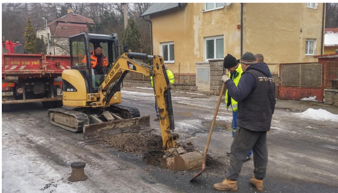
Obr. 3: Havárie na vodovodním řadu
